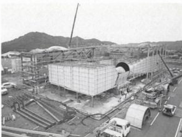
建設初期段階の様子。最初に風洞設備が組まれて、その後建物が組まれた
