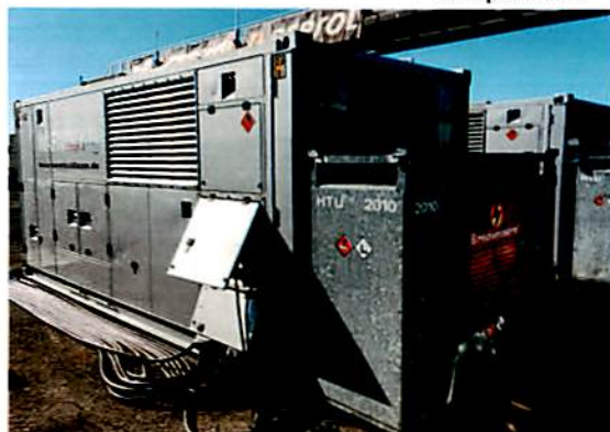
Drei Generatoren lieferten beim Test den Strom. Kraftstoff? Diesel. Wie peinlich!
