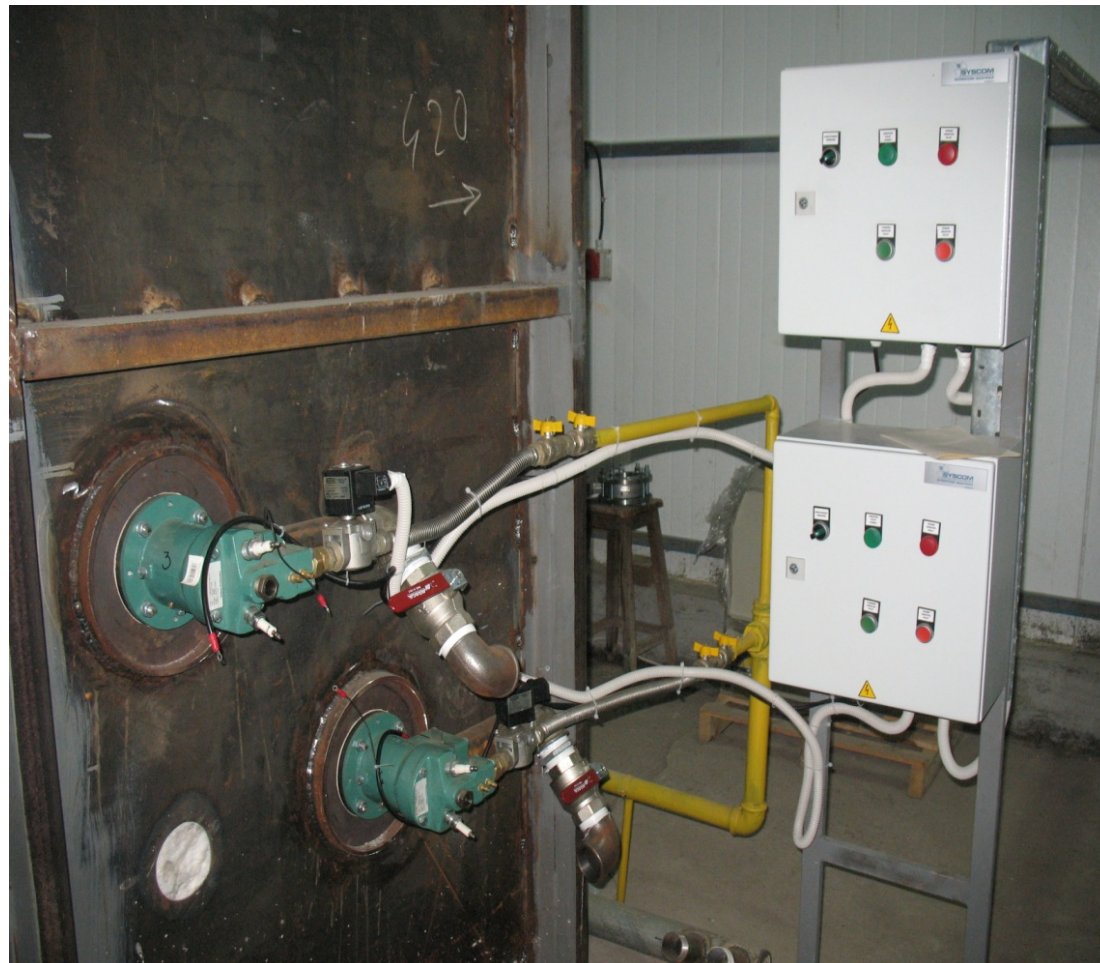
Fig. 5.7. Amplasarea arzătoarelor si a panourilor de automatizare aferente fiecărui arzător.
