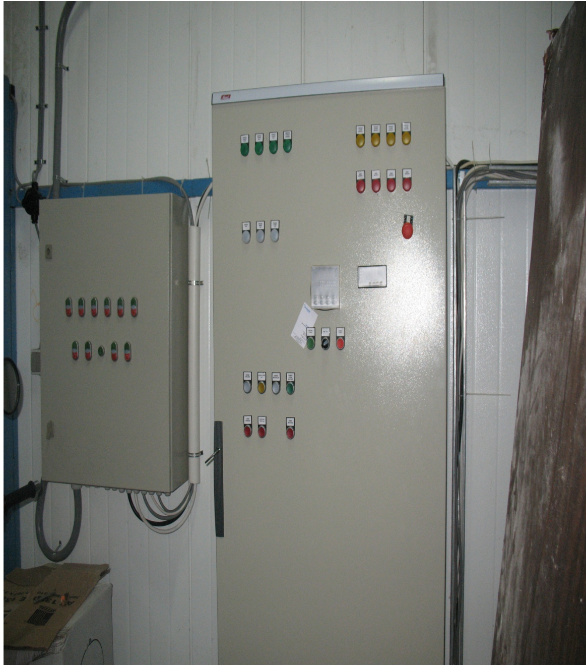
Fig. 5.8. Tabloul general de alimentare și tabloul de automatizare.
