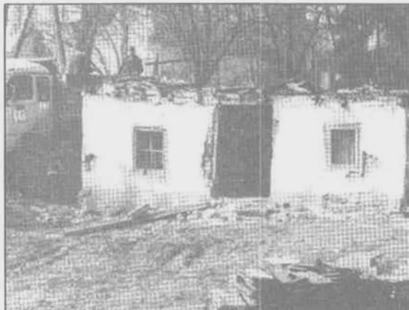
Срушен кров на кућеру
