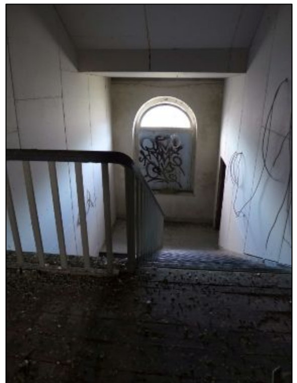
dto., vom Ober- zum Dachgeschoss mit starken Verunreinigungen durch Vogel-(Tauben-)kot
