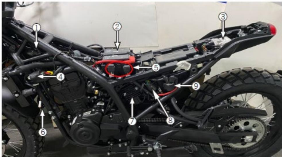
1 Verkabelung des linken Kombinationsschalters, Verkabelung des Kühlerlüfters, 2 Batterie, 3 ECU, 4 Verkabelung der Zündspule 5 Hauptrelais, Ölpumpenrelais, 6 Hupe, 7 Spannungsregelgleichrichter, 8 Magnetverkabelung, 9 Startrelais
