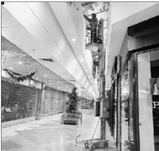
Exemplul 4: Curățarea acoperișurilor vitrate din interior utilizând o platformă ridicătoare mobilă de persoane (PRMP) cu elevație multidirecțională
