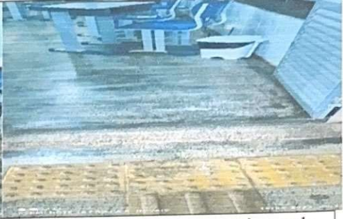
Foto 02- desnível entre passeio e sala
