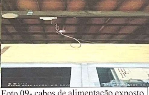
Foto 09- cabos de alimentação exposto
