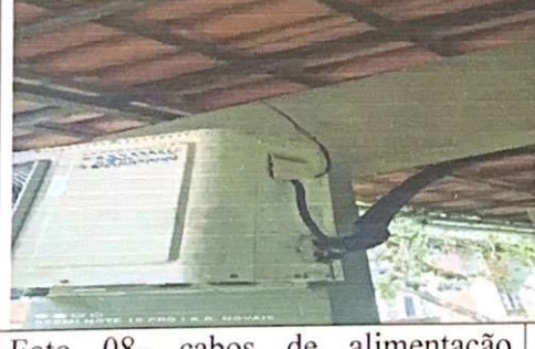
Foto 08- cabos de alimentação exposto
