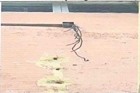
Foto 16- cabos sem isolamento
