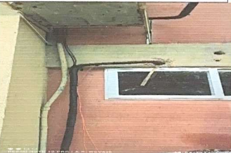
Foto 17- cabos sem isolamento
