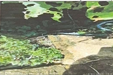
Foto 15- cabos soltos no chão
