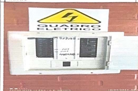
Foto 12- quadro de distribuição
