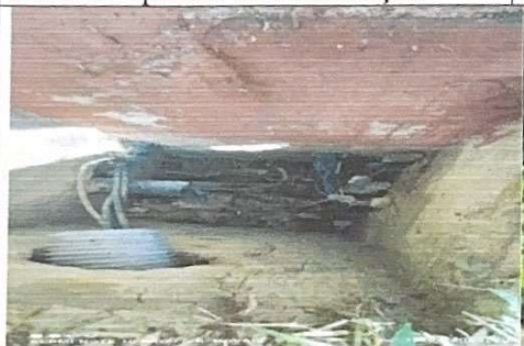
Foto 14- caixa de passagem elétrica
