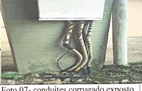
Foto 07- conduites corrugado exposto
