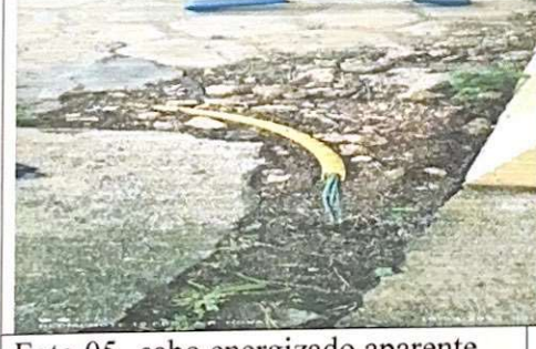
Foto 05- cabo energizado aparente
