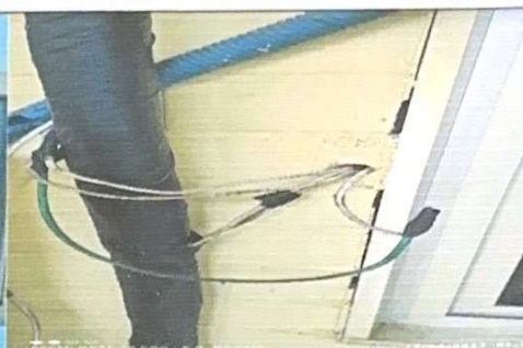
Foto 11- cabos de alimentação exposto
