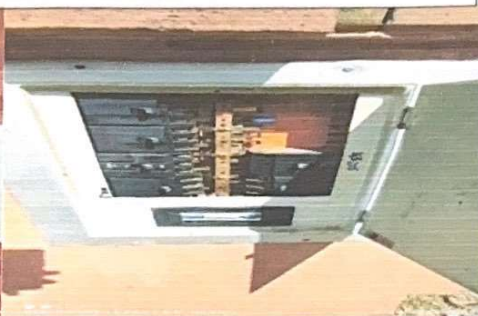
Foto 13- quadro de distribuição
