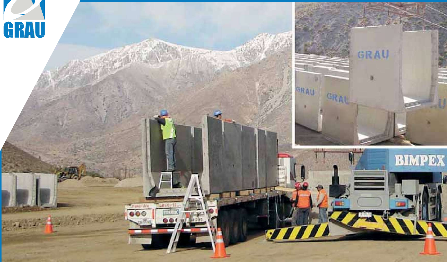
▲ Canaleta con tapa • Encauzamiento de río al interior de Mina Los Pelambres
