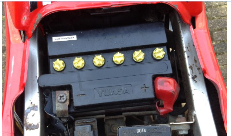
Kabels en schroeven netjes, kapje op de +pool aanwezig.
