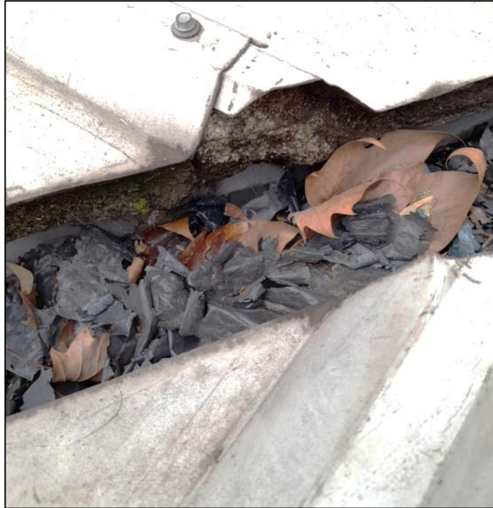
Figura 26: Indicios de basura en las canaletas de aguas lluvias
