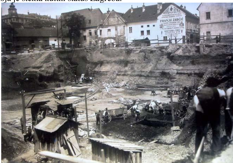
Radovi na izgradnji tržnice i zgrade Tržnoga nadzorništva počeli su sredinom srpnja 1927. i završeni su 1930. godine, MGZ 52838
