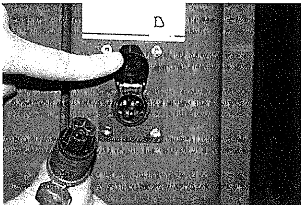
Fig. 3 Priza exterioara pentru conectare la 220V
