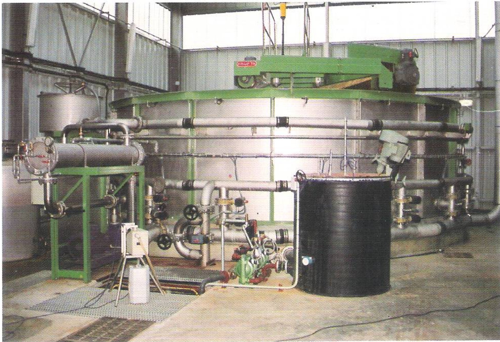
Krofta SANDFLOAT Tipo SAF-BP - 24 Recuperación de Metales Pesados
