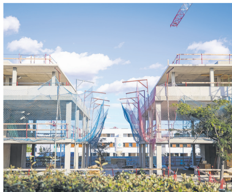
Habitatges en construcció a Can Gambús, una de les zones on pot créixer Sabadell, juntament amb Cifuentes /VÍCTOR CASTILLO
